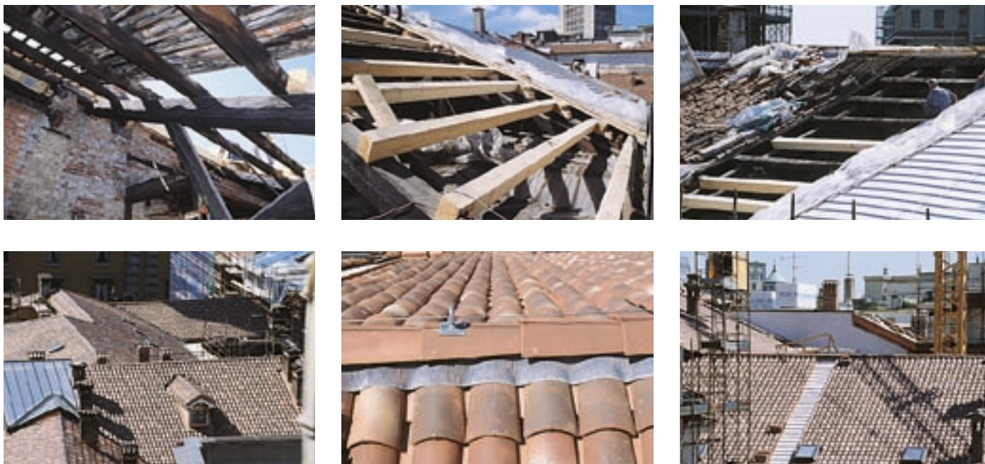
Sostituzione del manto di copertura in coppi e realizzazione della linea di colmo ventilata.
